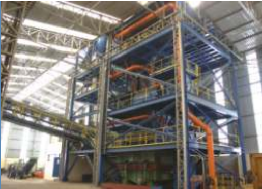
Sistema de recuperação e preparação de areia verde
