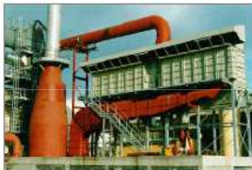
Área de filtração aprox.1.650 m 2
