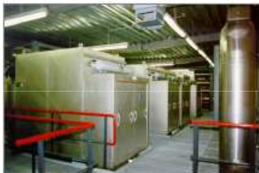
Área de filtração 4 x aprox.110 m 2
